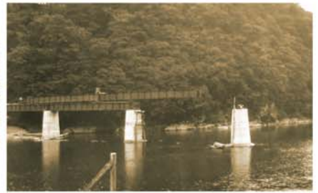
室戸台風で流失した鶴岡橋梁の復旧工事 〔昭和 11 年（1936）／提供：荒井憲治〕
